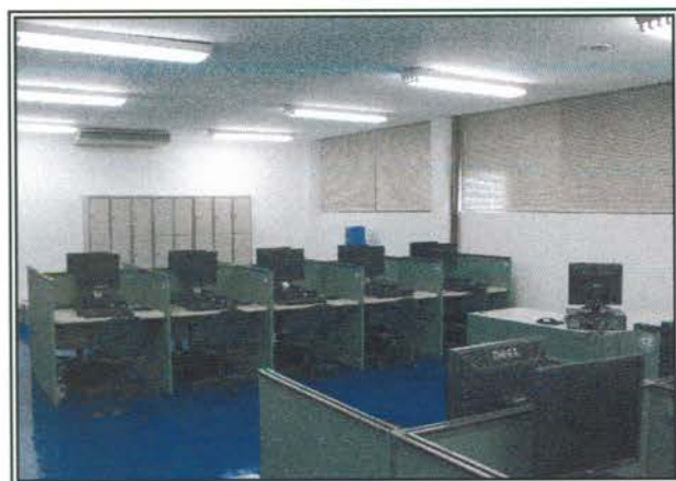
Supervisão/Central de Processamento de Dados
